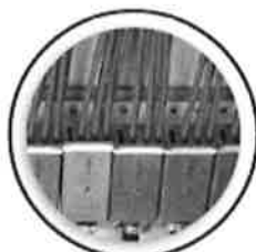
&gt; Arrimage des câbles
