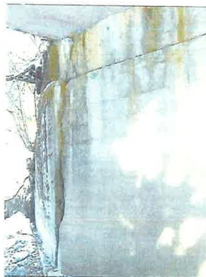
Déplacement mur en aile aval (> 15 cm)
