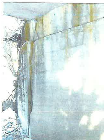
Déplacement mur en aile aval (> 15 cm)
